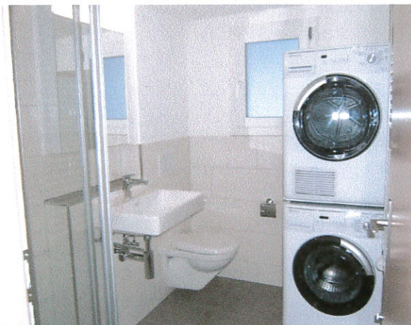
Dusche / WC mit Waschturm
